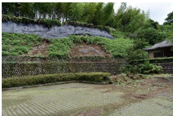
（令和2年7月8日・山鹿市教育委員会） 被災状況
