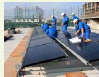
太陽光発電設備(屋上実習)
