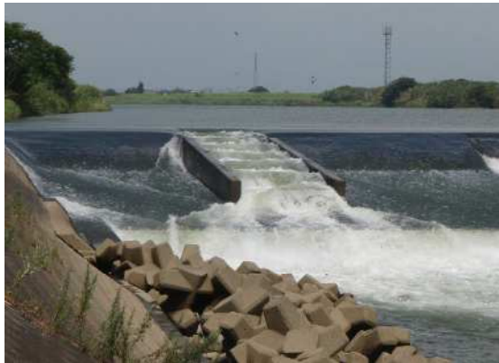
写真 4.2-7 杉島堰の魚道
