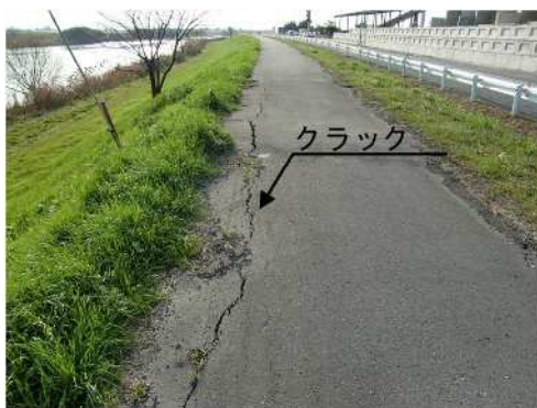
写真 2.1-9 堤防天端のクラック
