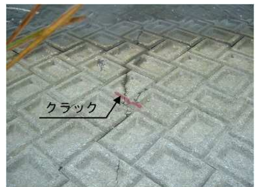
写真 2.1-10 護岸のクラック
