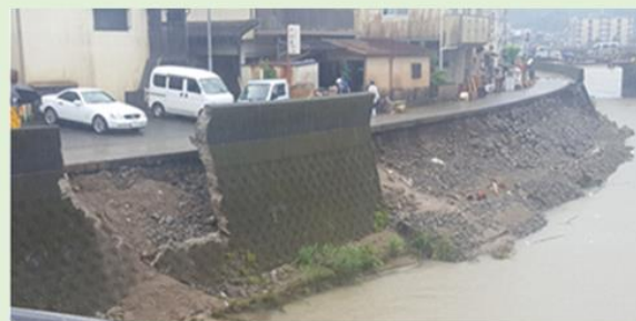
令和2年7月豪雨時の堤防護岸の崩壊状況
