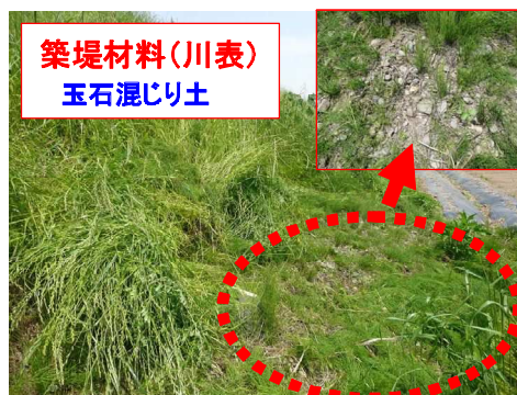
写真 2.1-11 堤防法面の土質 堤防の材料が不均質となっている
