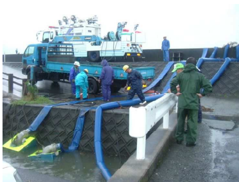
写真 2.1-2 加勢川における内水被害状況 (平成19年(2007年)7月 熊本市南区野田地区)
