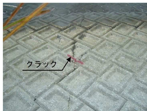
写真 2.1-10 護岸のクラック
