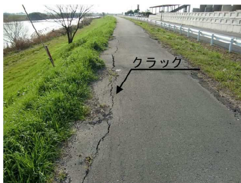
写真 2.1-9 堤防天端のクラック
