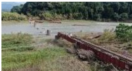
流失した球磨川第4橋梁
