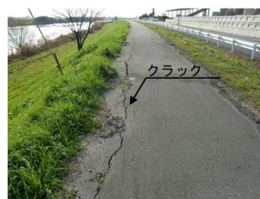
堤防天端のクラック
