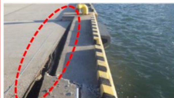
-7.5m岸壁のひび割れ
