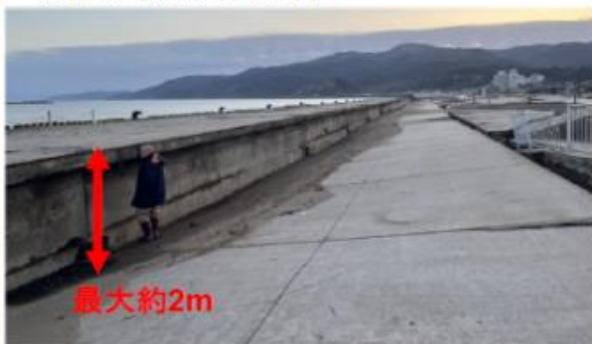
-7.5m岸壁背後荷捌き地の沈下
