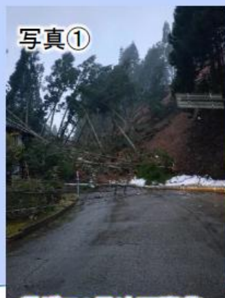
県道51号法面崩落
