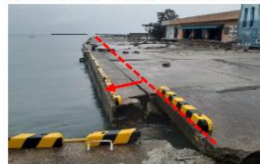
-5.5m岸壁のズレと沈下
