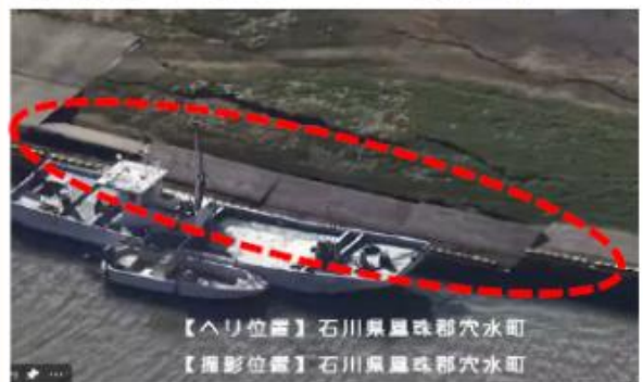
-4.0m物揚場の倒壊
