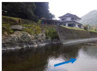
被害状況（令和2年7月時点）
