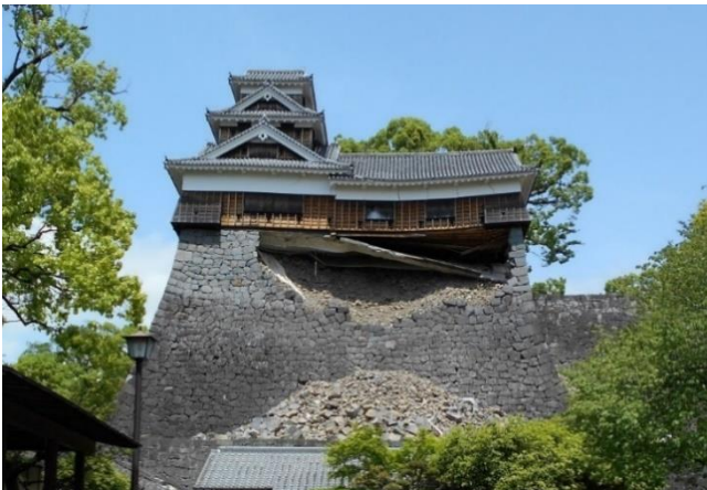
2016年4月22日 飯田丸五階櫓被災状況
