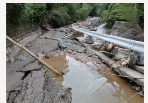
県道梶屋多良木線(提供:多良木町)
