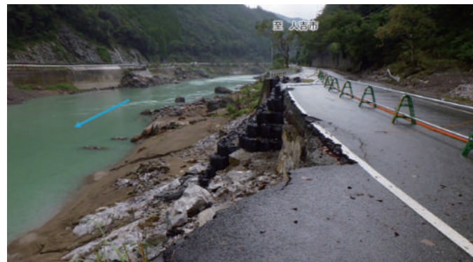
被災状況(国道219号:八代市坂本町川嶽地区)
