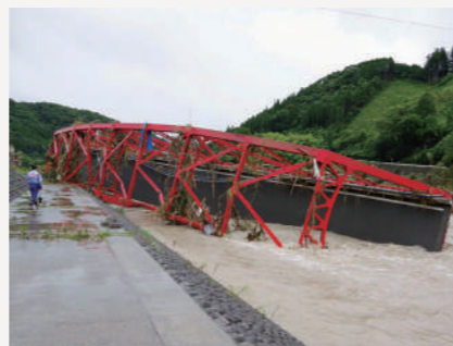
流出した相良橋
