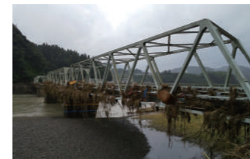
被災した西瀬橋(人吉市)
