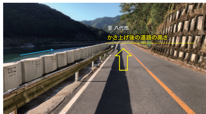
復旧状況(道路の復旧:かさ上げ)R5.11.7 至 八代市 かさ上げ後の道路の高さ
