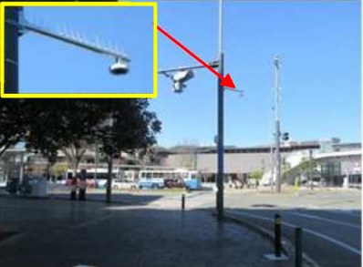
熊本駅周辺に増設した防犯カメラ
