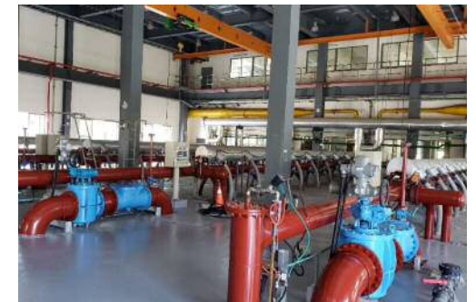
下水処理場内状況(新竹サイエンスパーク)
