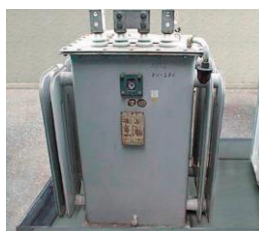
トランス（変圧器）
