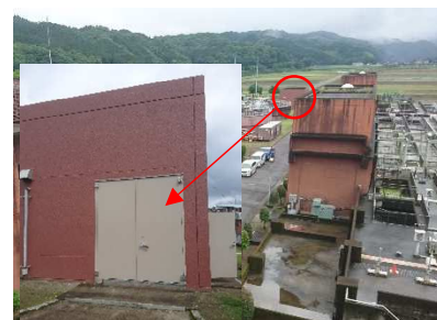
下水処理場の災害復旧と併せた防水扉への交換（人吉市）
