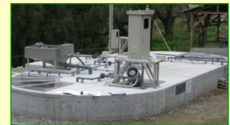
整備された浄化槽
