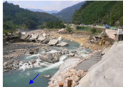
平成 18 年 7 月洪水による竹の川発電所 取水堰の被災状況 (五木村)
