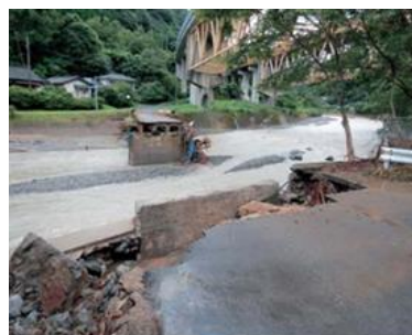
令和2年7月豪雨による万江川の 足算瀬橋流失状況 (山江村)
