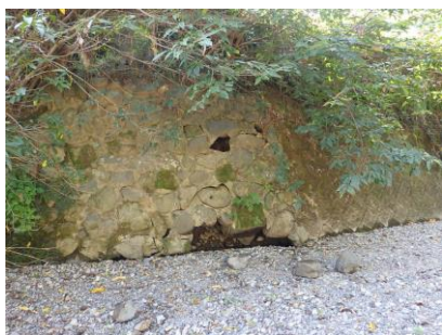
写真 2.6 巡視で確認された護岸欠損箇所
