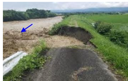
令和2年7月豪雨による免田川の堤防欠損状況（あさぎり町）
