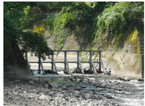
写真 5.2 流木止工施設の例 (油谷川下流)
