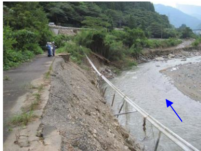
平成 24 年 7 月洪水による旧県道宮原五木線の 被災状況 (五木村)
