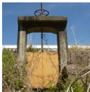
写真 2.7 老朽化した樋管
