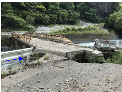
写真 2.2 令和2年7月豪雨における梶原川の土砂・流木による橋梁の被害状況
