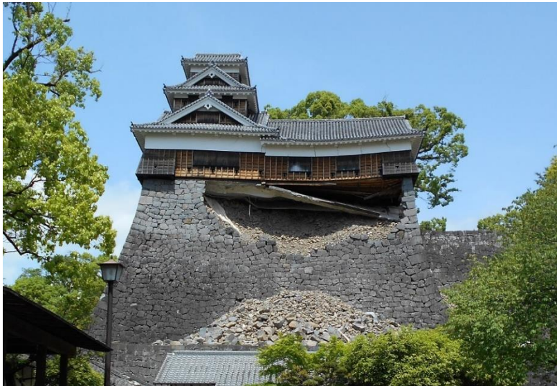
2016年4月22日 飯田丸五階櫓被災状況
