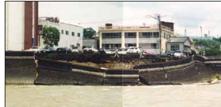
基礎洗掘により護岸が崩壊した球磨川の事例 (山田川合流点(H8.7.3~8の出水後)) 軟岩の人吉層が洗掘された場合でも同様の崩壊が発生する可能性がある。
