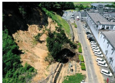
<R2. 7月豪雨による山地災害の状況>
