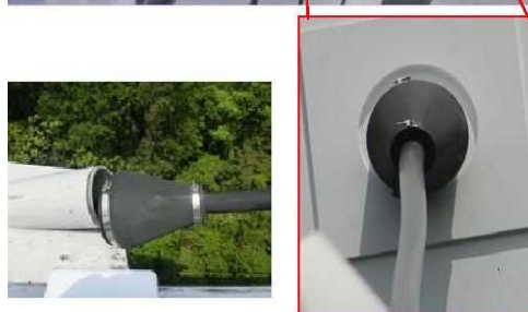
写真－1.9.5 ケーブルたわみの例
