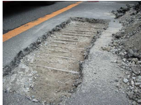
床版上面土砂化状況
