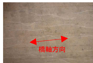
写真－1.9.2 主桁橋軸方向の桁下の ひびわれ損傷例
