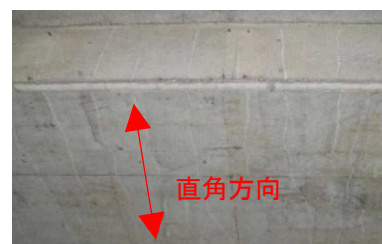
写真－1.9.3 主桁直角方向の桁下および 側面のひびわれ損傷例
