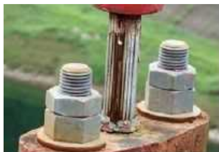
写真－1.9.6 吊り材の腐食の例
