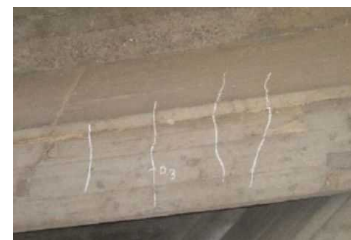
写真－1.9.1 支間中央ひびわれ損傷例 (T 桁下面および側面)
