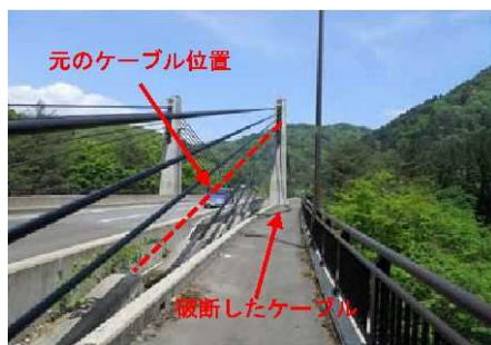
写真－1.9.4 ケーブル破断の例
