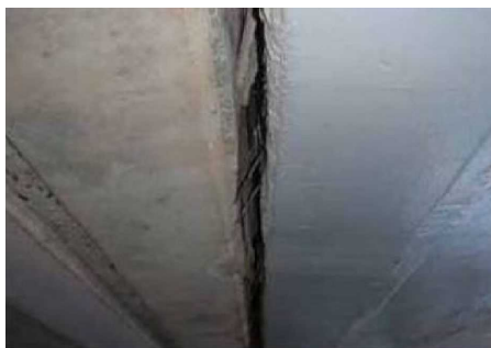
プレテン桁間詰め材の欠損
