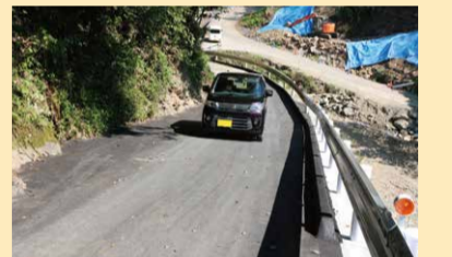
通行可能となった相良村小柏地区の村道
