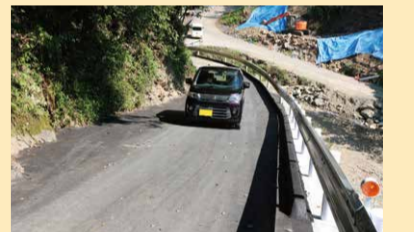
通行可能となった相良村小柏地区の村道
