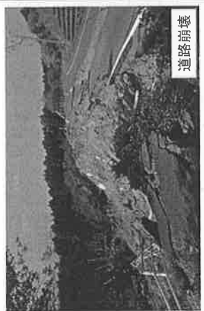
③土工部の被災状況
