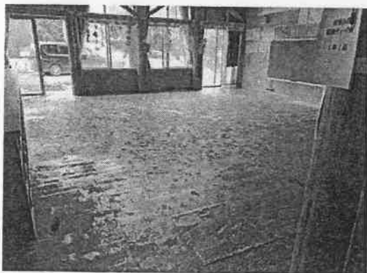
【芦北町立佐敷小学校(床上浸水跡)】
