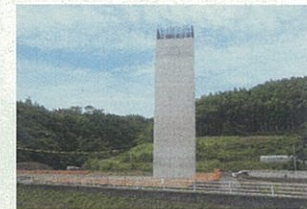
工事名:砂原四方宮城地域連携推進施設改修工事 企業名:株式会社横組 現場代理人主任技術者:下田隆士 優れた点:コンクリートのクラック防止対策に積極的に取り組むとともに、鉄筋の定着に新技術のTヘッドバーを使用するなどの創意工夫を行った。
