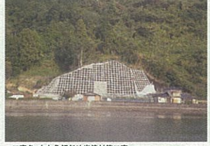
工事名:大丸急傾斜地崩壊対策工事 企業名:有限会社吉田工業 現場代理人主任技術者:洲上 誠 優れた点:法枠の格子部において頭部プレートと法枠のかぶり確保や、確実なモルタル充填の工夫とともに、地形変化にマッチする法枠配置の見直し等の創意工夫を行った。
