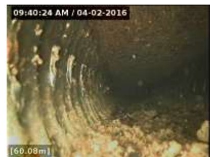
図2 付着物・土砂堆積が少程度の暗渠管内の状況
