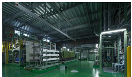
水処理プラント
