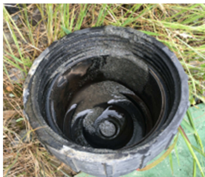
写真 井戸施設に詰まった砂
