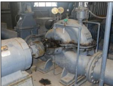
写真① 既設ポンプの状況
