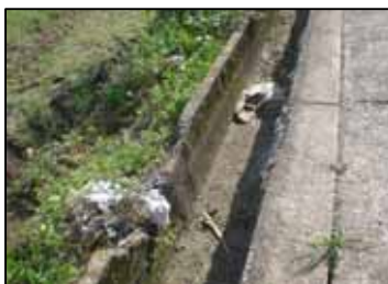
写真 用水路の老朽化、破損
