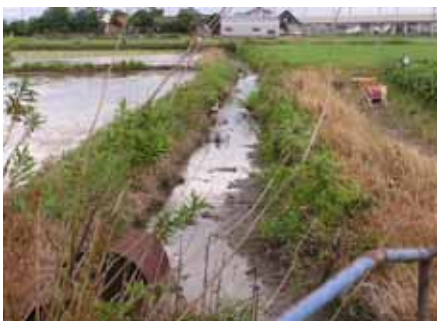
現況水路は法面崩壊、堆積土により排水断面が不足し排水不良を来している
