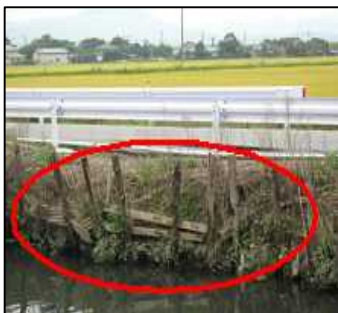
写真① 排水路の法面崩壊状況
