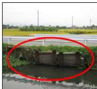
写真② 排水路の法面転倒状況
