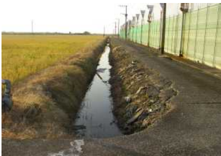
現況の土水路は法面崩壊があり、維持管理に多大な労力を要している
