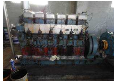
昭和同仁排水機場は40年を経過して、いつ機能停止するか分からない状況である
