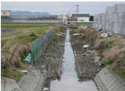
現況の土水路は法面崩壊があり、維持管理に多大な労力を要している
