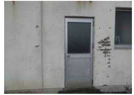
野崎排水機場は27年を経過して、建屋も老朽化し、海岸堤防吐出樋管から漏水がある
