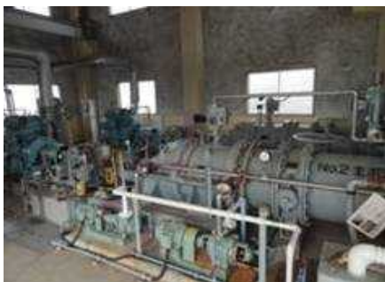
ポンプ設置から27年が経過し、施設の維持管理に苦慮している状況
