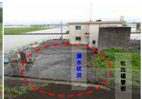
潮の干満により海岸堤防内の吐出樋管から漏水が発生しており、早期の対策が必要である
