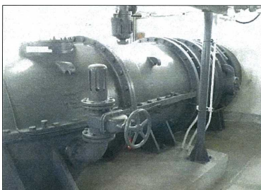
写真① 排水ポンプの状況
