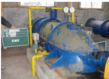
写真① 老朽化した揚水機場の状況
