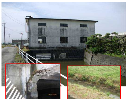
写真① 老朽化した排水機場機場の状況及び水路の状況
