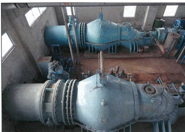
写真① 排水ポンプの状況
