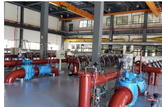
下水処理場内状況(新竹サイエンスパーク)
