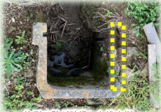
片側の壁が破損した排水柵
