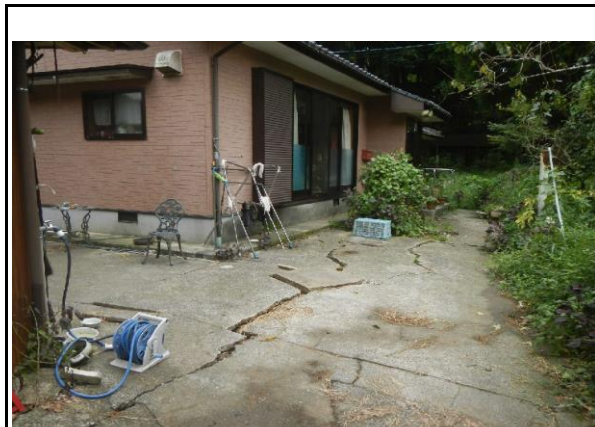
人家の庭に生じた亀裂
