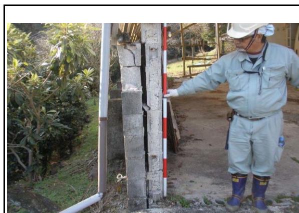
人家擁壁の変状
