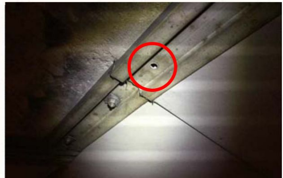
付写真-1.10 導水樋の止め金具が脱落した例
