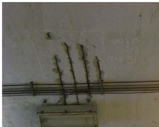
付写真-2.2 鋼材腐食の例
