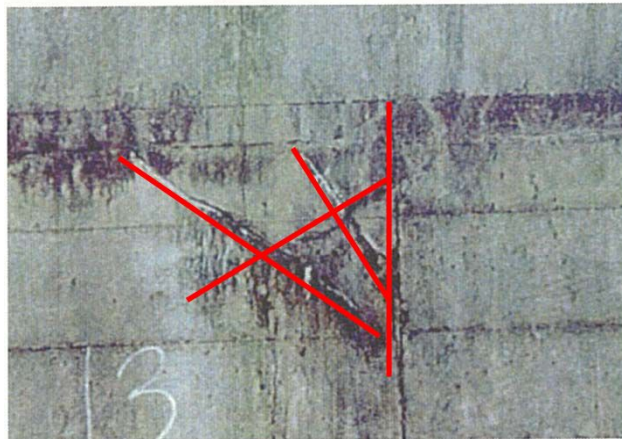
付写真-2.1 ブロック化したひび割れの例
